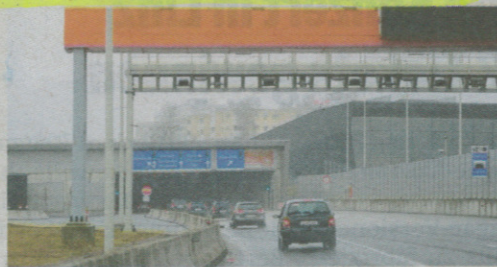
Zur Entschärfung wurde eine Verkehrsbeeinflussungsanlage installiert.
